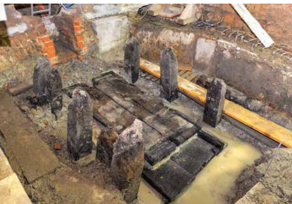
Blick hinter die Fassade des Asamgebäudes: Feuchtigkeit, der schlechte Zustand des Mauerwerks und der Sensationsfund einer historischen Wasserpumpe verlängern und verteuern die Generalsanierung.
